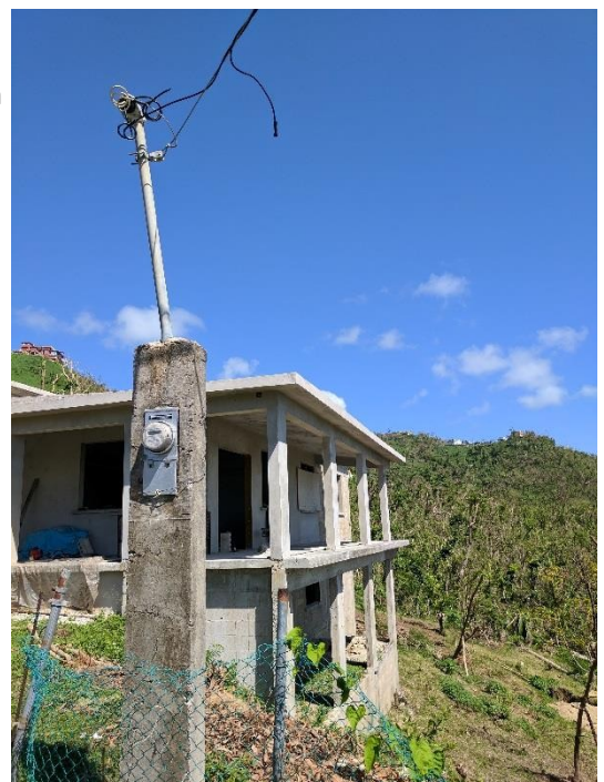
Imagen 5. Contador eléctrico elevado en un pedestal de cemento en una casa en construcción en Yabucoa.
