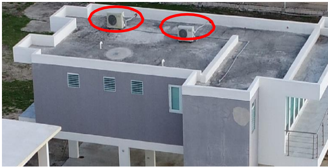
Imagen 9. Equipo de calefacción, ventilación y aire acondicionado (HVAC) (óvalos rojos) anclado al techo de cemento en Humacao.
