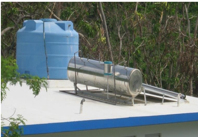
Imagen 4. Calentador solar de agua y tanque de agua anclados en un techo de cemento en Rincón.
